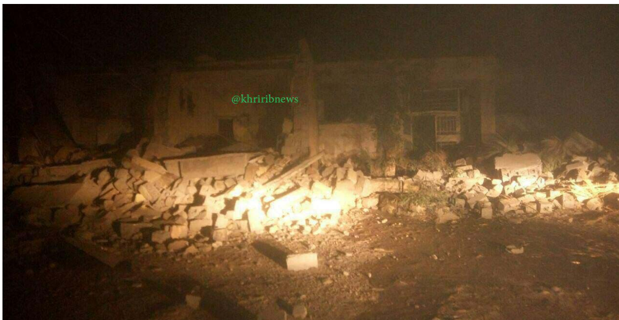
شکل ۴-۷ تخریب دیوار منزل مسکونی در سرپل ذهاب
