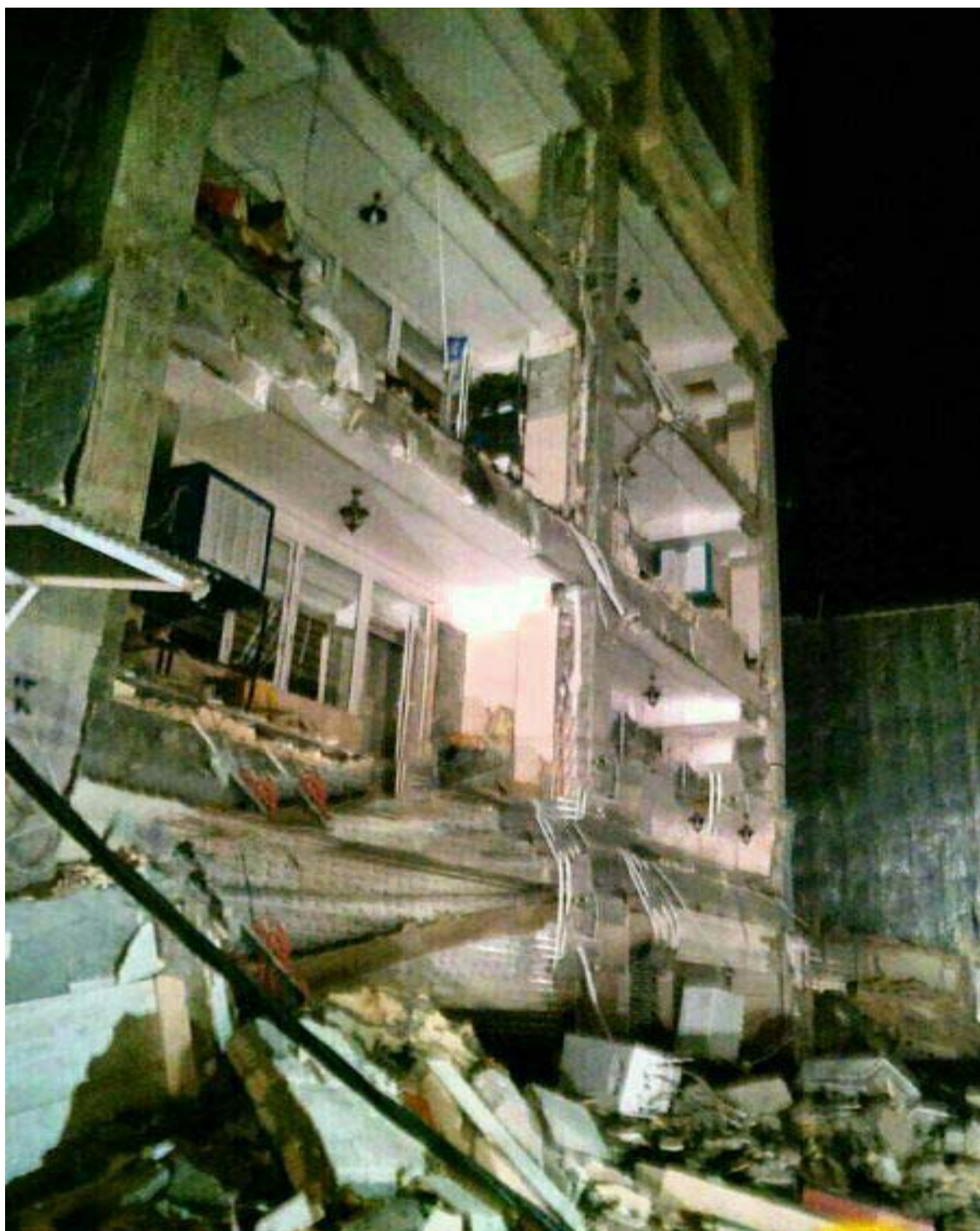
شکل ۴-۱۰: تخریب دیوار پیرامونی به همراه نما و تجهیزات وابسته در اسلام آباد غرب
