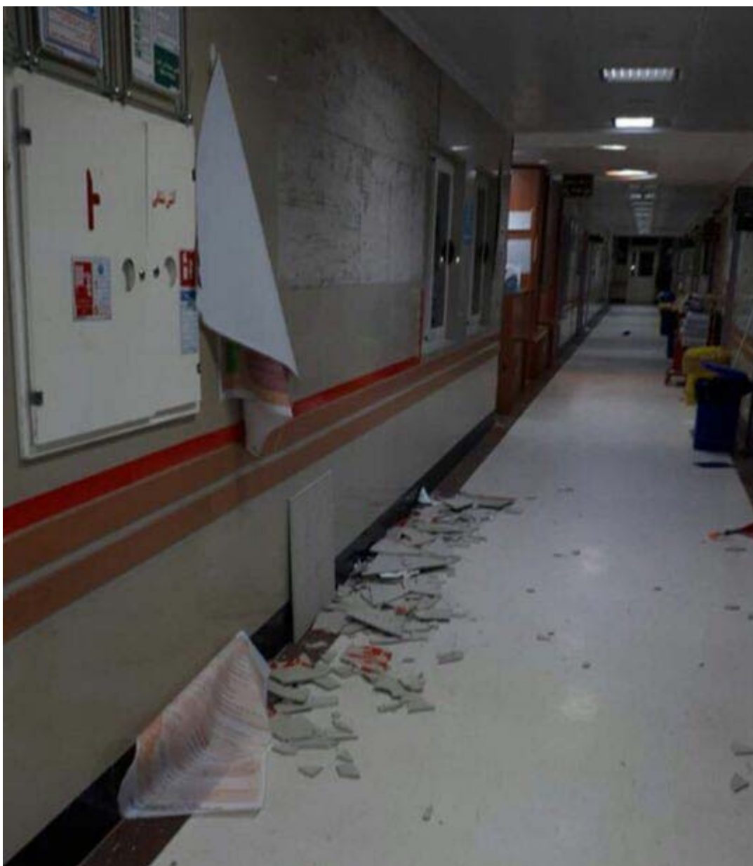
شکل ۴-۱۳: ریزش پوشش دیوارهای داخلی در ایلام
