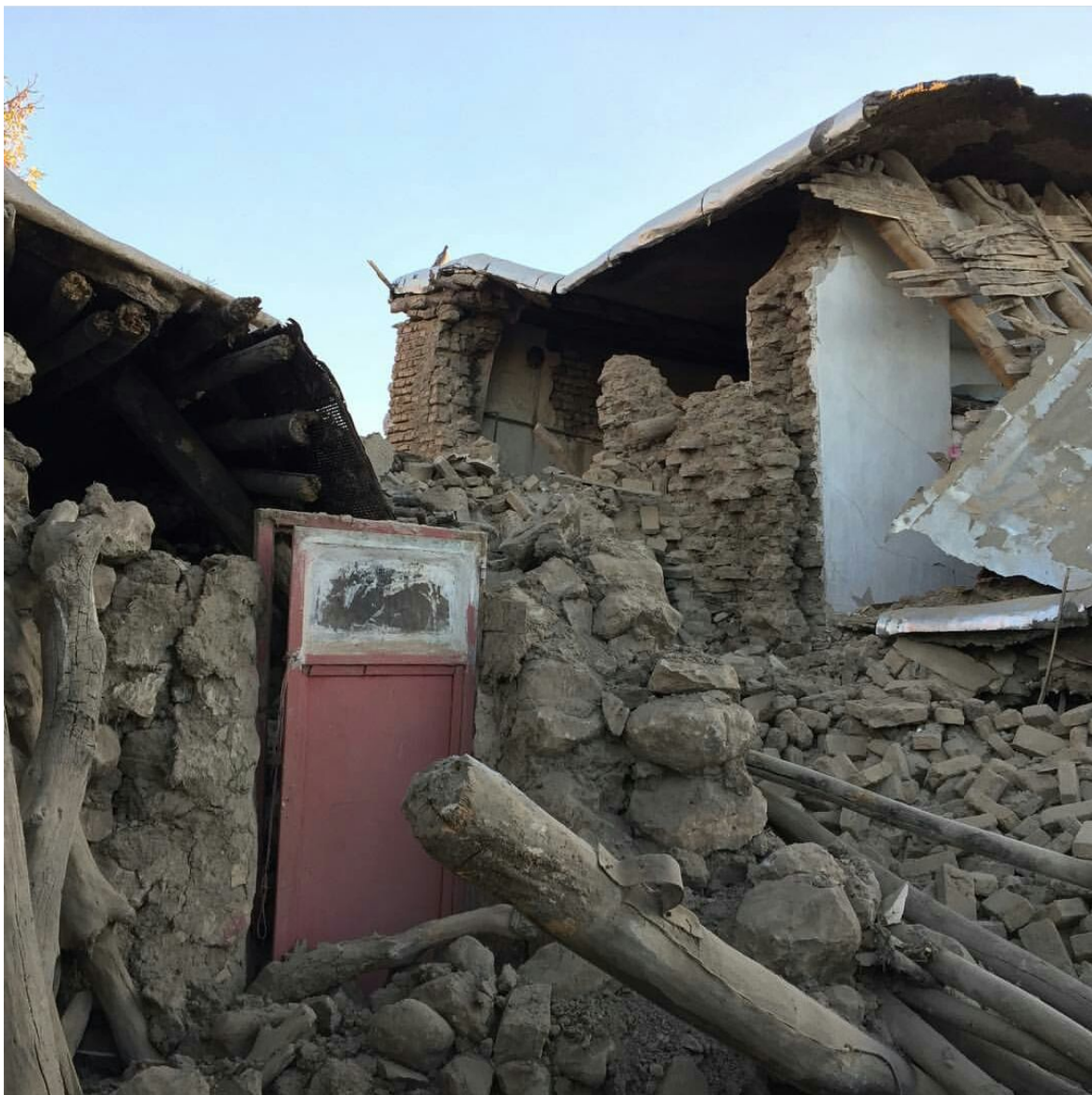
شکل ۴-۲۵: تخریب ساختمان‌های روستایی با مصالح بنایی در روستای دهجانی
