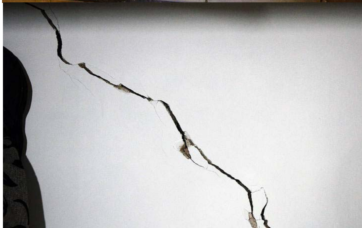
شکل ۴-۱۸: ترک‌های بروز یافته در جداره دیوارهای ساختمان در سنندج
