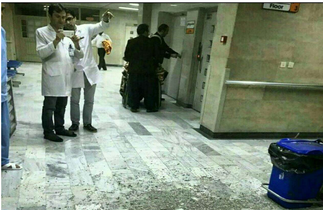
شکل ۴-۱۵: تخریب و ریزش مصالح سقف در بیمارستان ارومیه
