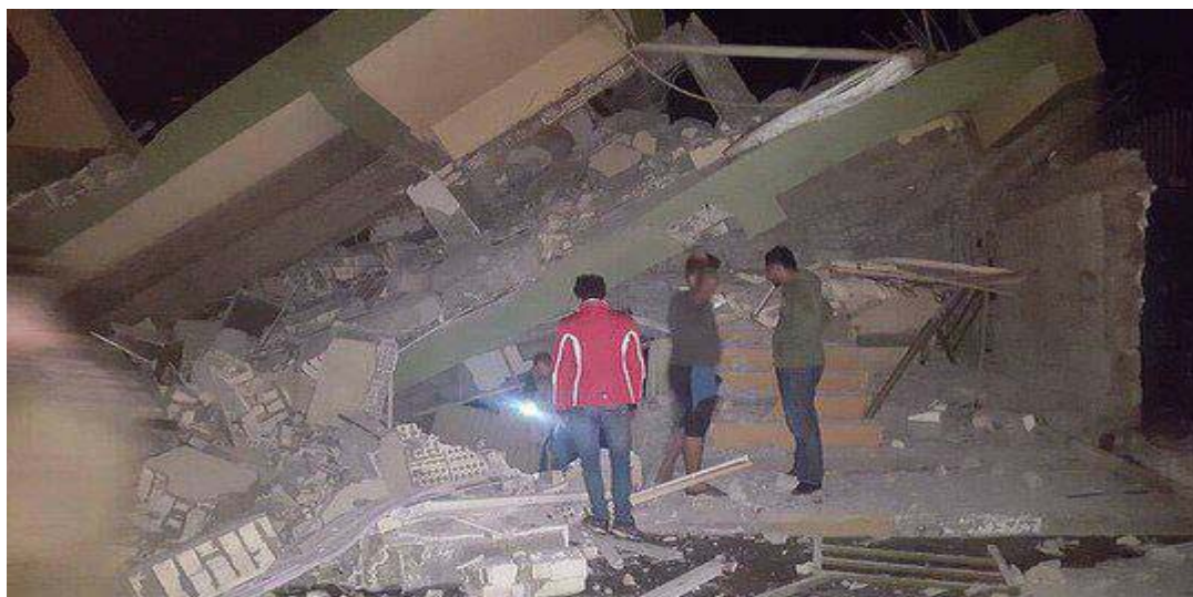
شکل ۴-۲۰: ریزش کامل ساختمان در سلیمانیه عراق
