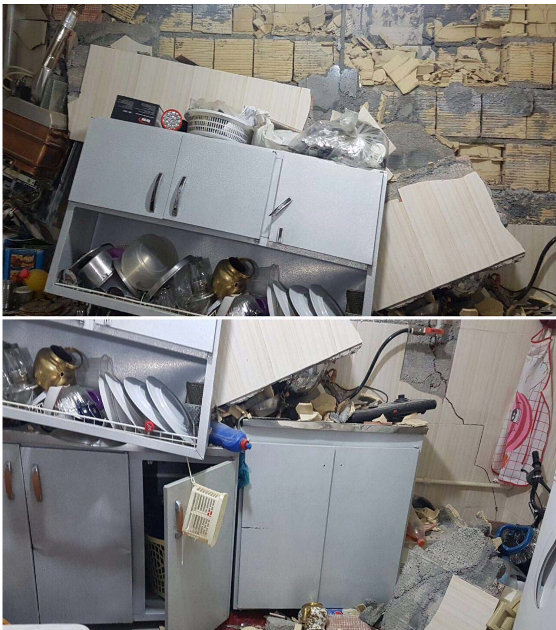
شکل ۴-۱۴: تخریب و ریزش پوشش دیوارهای داخلی در روانسر
