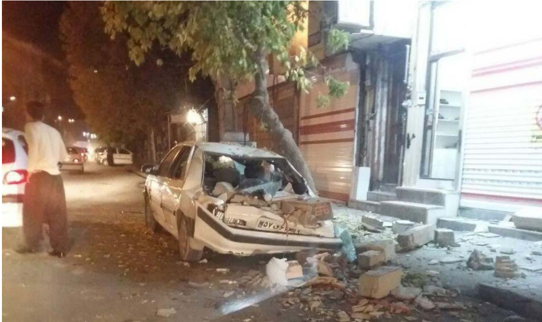
شکل ۴-۵: ریزش نمای ساختمان بر روی خودرو در جوانرود کرمانشاه
